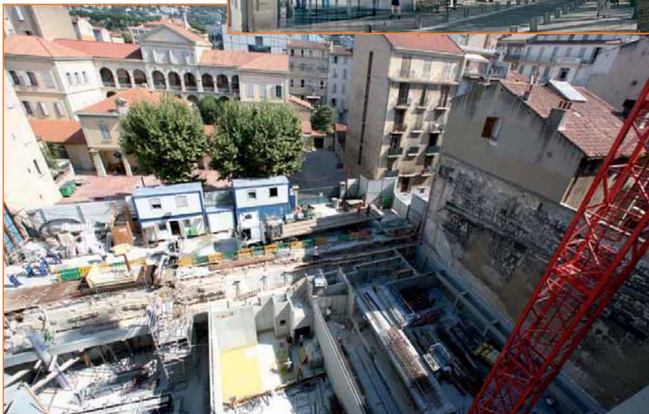
Le gros œuvre du Théâtre Liberté est en bonne voie : un chantier difficile.
